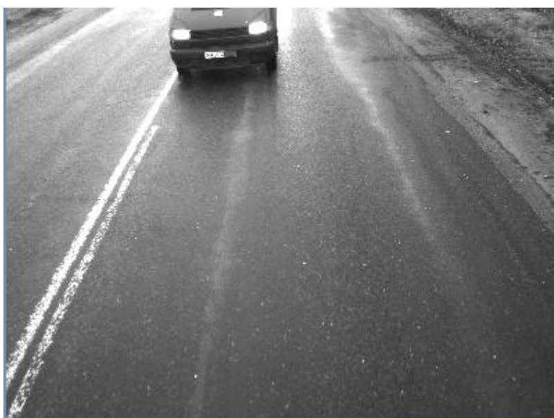
Рисунок 1.8 – Дефекти у вигляді колійності, км 169+320
