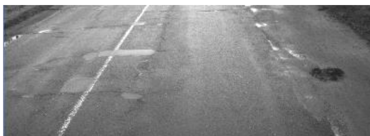
Рисунок 1.5 – Дефекти у вигляді поперечної та поздовжньої тріщини та вистришування, км 86+100
