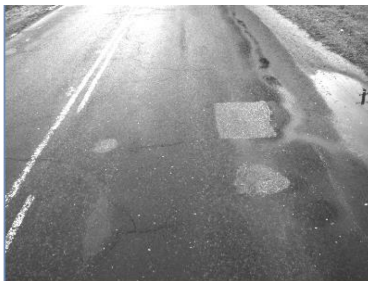
Рисунок 1.7 – Дефекти у вигляді косих тріщин, викришування та колійності, км 151+180
