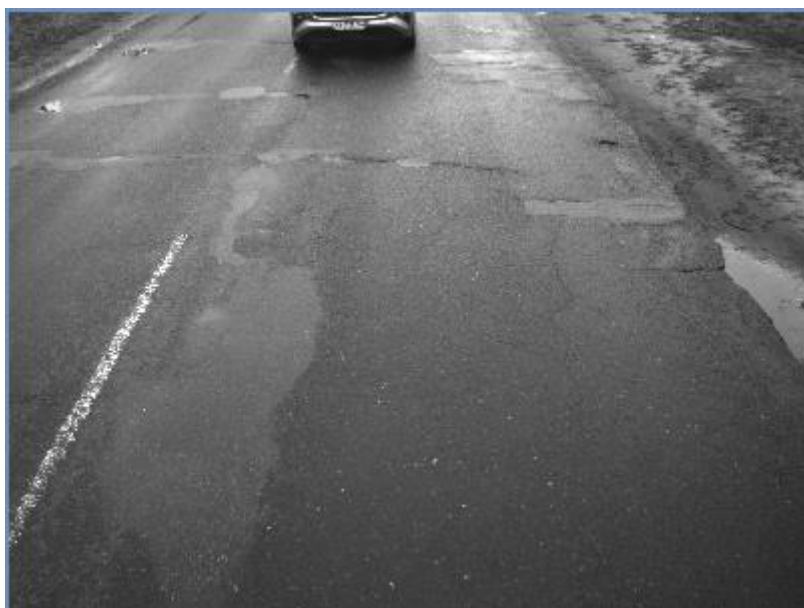
Рисунок 1.6 – Дефекти у вигляді поперечної та поздовжніх тріщин та викришування, км 140+320
