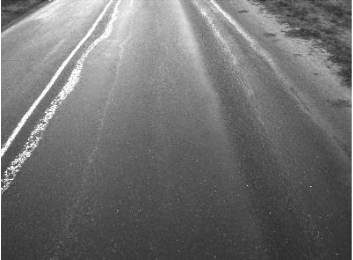
Рисунок 1.8 – Дефекти у вигляді колійності, км 119+480
