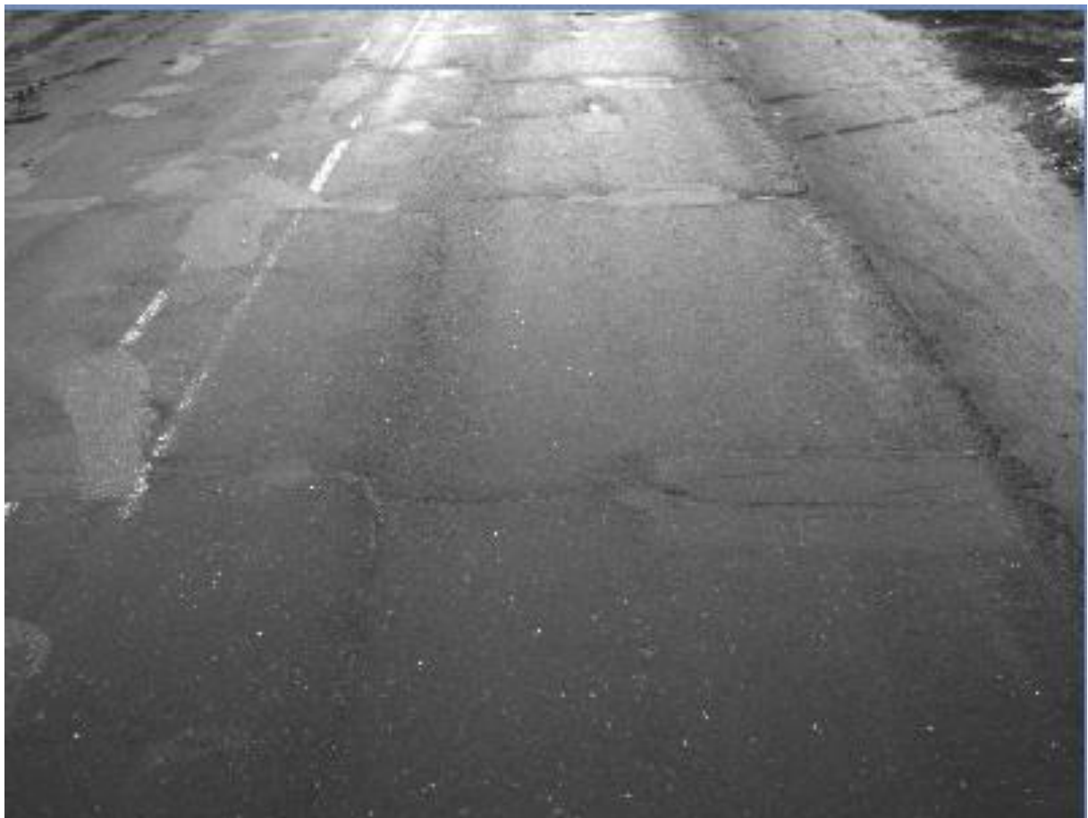
Рисунок 1.7 – Дефекти у вигляді поперечних тріщин, км 118+370
