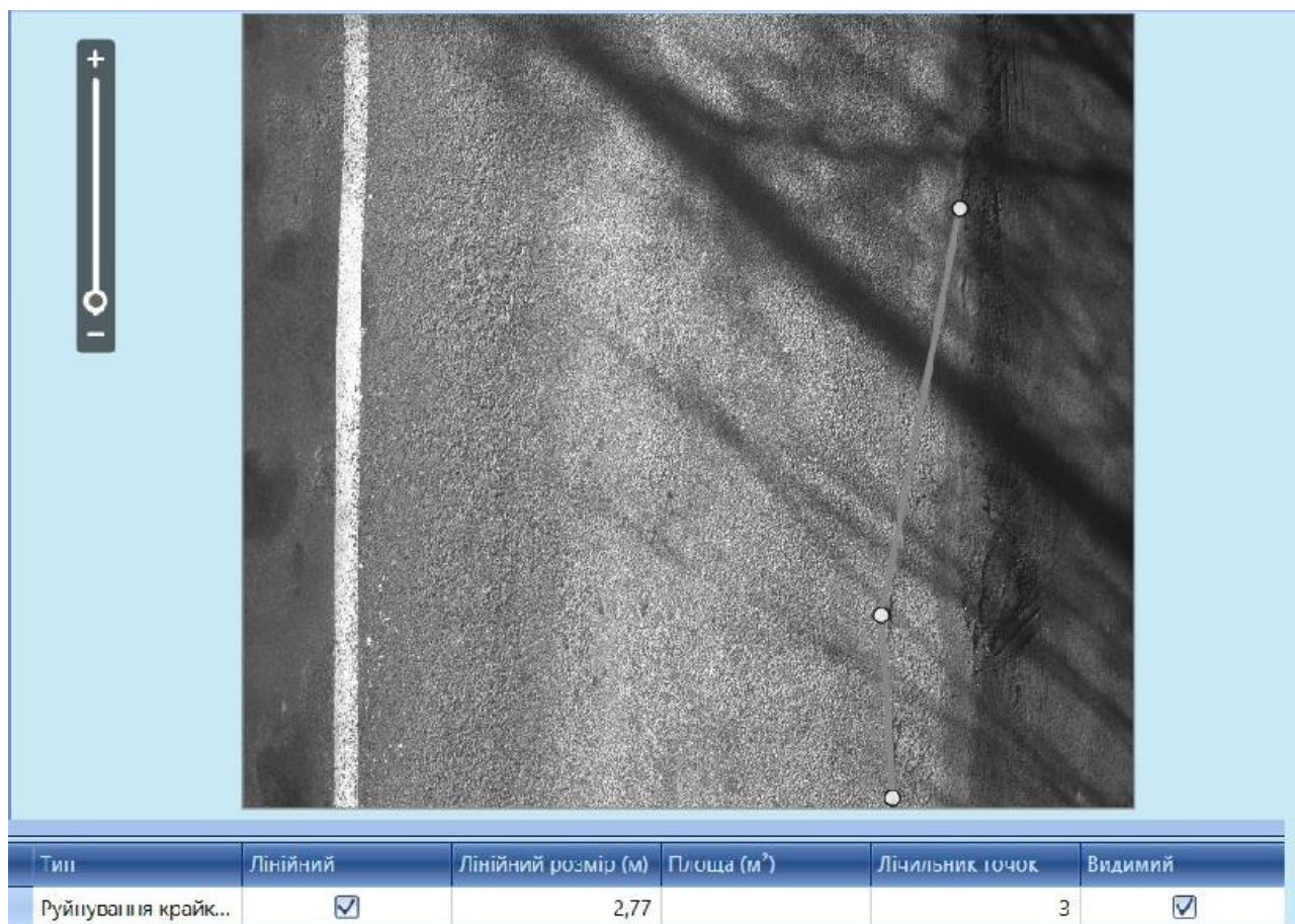
Рисунок 1.3 – Дефект у вигляді повздовжньої тріщини, км 96+800
